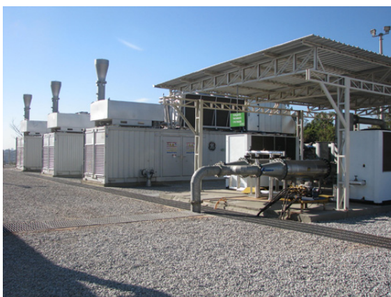
Figura 4: Estação de aproveitamento de biogás.
